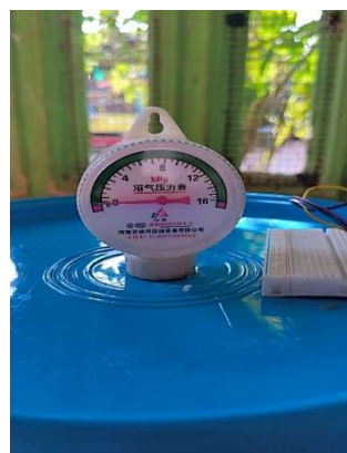
Gambar 6. Kenaikan tekanan pada biogas manometer
