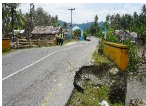
Gambar 5. Kerusakan pada oprit jembatan. Sumber: BPJN XIV Palu, 2019
