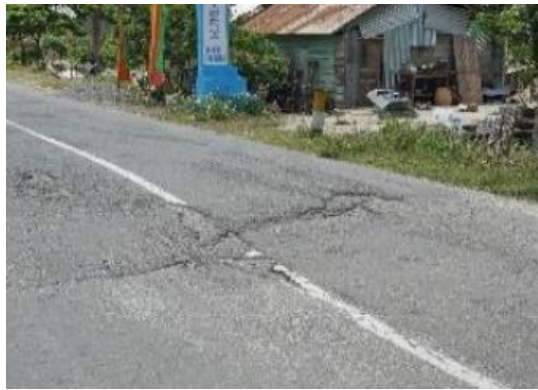
Gambar 4. Kerusakan permukaan jalan pada KM 90+200. Sumber: BPJN XIV Palu, 2019
