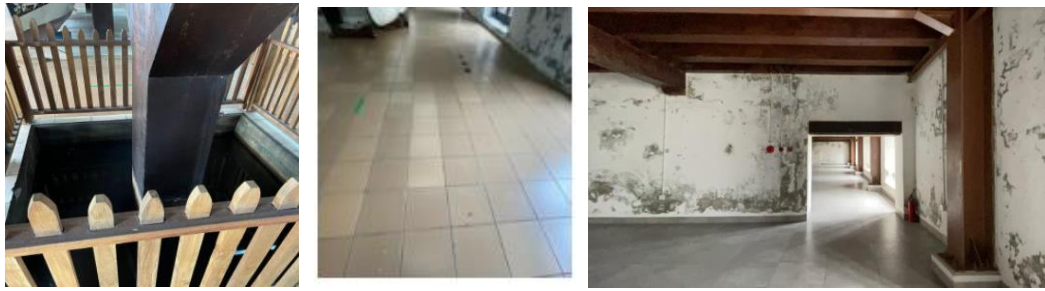
Gambar 8. (kiri ke kanan) Lubang lantai, material lantai dan dinding yang mengelupas
